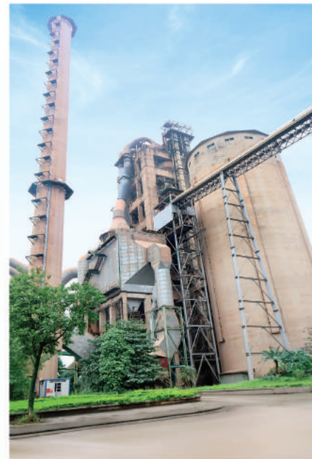
07 Hệ thống lọc bụi tĩnh điện
