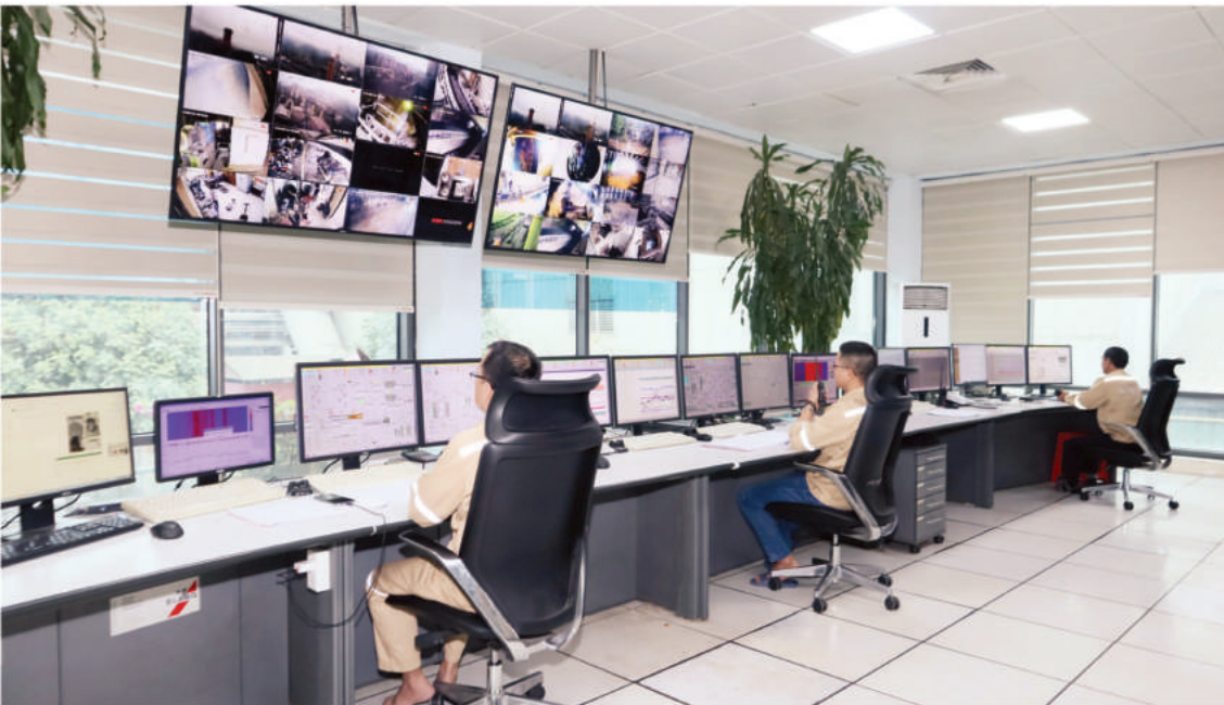
Phòng điều khiển trung tâm (toàn bộ quá trình sản xuất, đồng xử lý được tự động)
