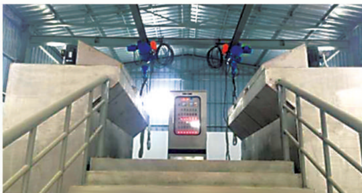
Thiết bị điều khiển xử lý khí thải NOx của lò nung clinker
