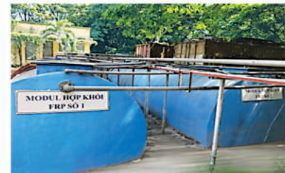
Hệ thống xử lý nước thải
